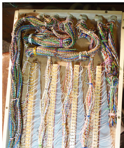
Abbildung 6: Fertiggestellter Verteiler. Die Flachbandkabel gehen nach unten.
