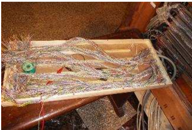
Abbildung 7: Einer der 3 Verteilerkästen mit den Kabeln aus dem Spieltisch
